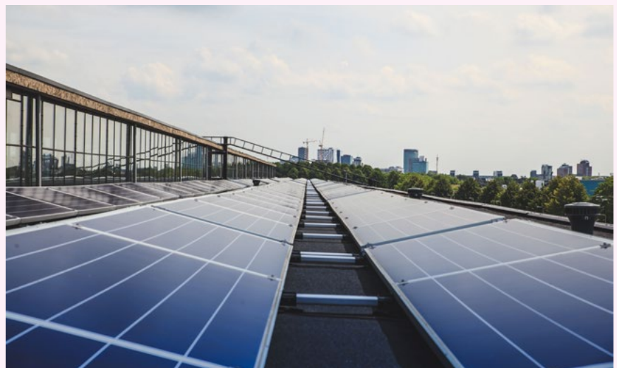
Promovendus Frank Kreuvel ontwikkelde een programma dat tot op de minuut voorspelt hoeveel zoninstraling er zal zijn en dus hoeveel energie er wordt opgewekt. Op de foto: zonnepanelen op het dak van de Werkspoorfabriek in Utrecht. • Foto Jeroen van de Water/Unsplash
