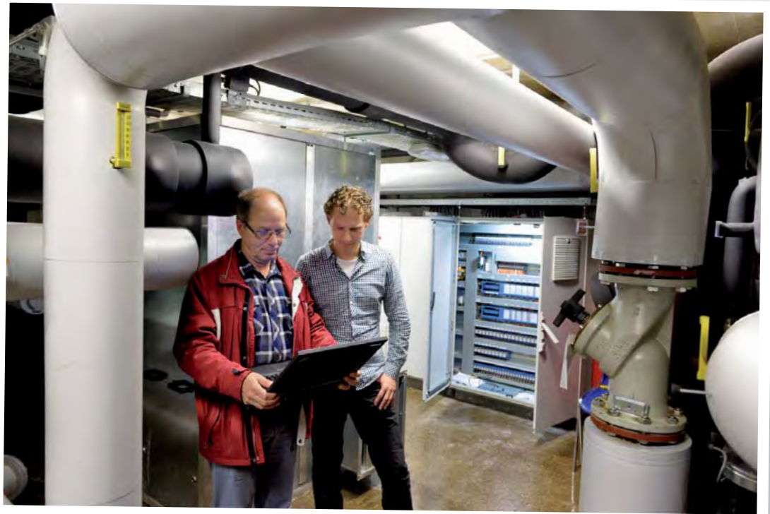
Projectleider Regeltechniek Dick van Hoften (links) en energiecoördinator Michiel van der Wal in de machinekamer van Orion. Dat gebouw heeft een eigen, modern systeem voor warmte-koudeopslag.
